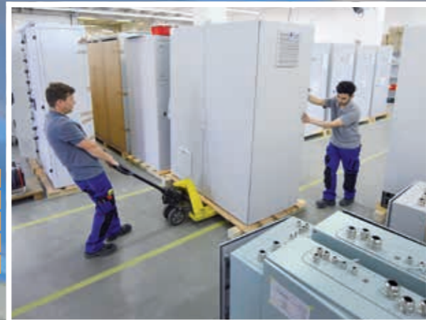
Schwere Last: Der Schaltschrank auf dem Hubwagen wiegt annähernd 700 Kilogramm.
